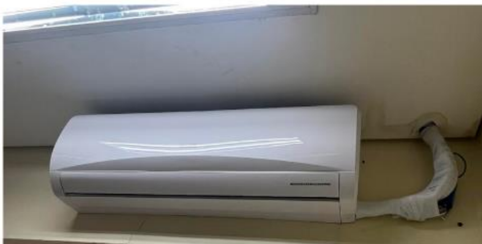
Novo ar condicionado no laboratório de TI do Polo Canoas
